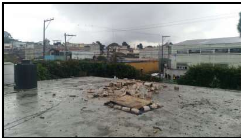
Fotografía No.: 18 Vista del daño y destrucción a la chimenea de la vivienda y senda vuelo de destrucción por impacto.
