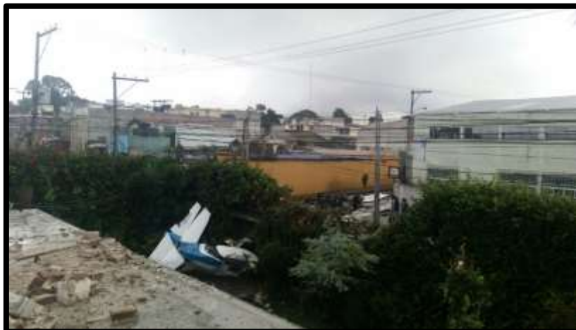
Fotografía No.: 21. Daño a la terraza, pared y restos de la aeronave.
